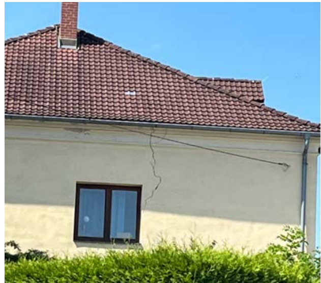
Die Bruchstellen an der Alten Volksschule Penk
